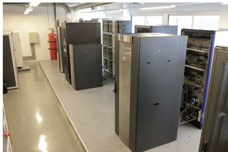
Nuevo CPD en el Edificio I+D
